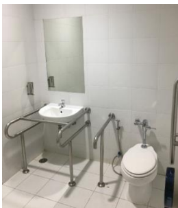
รูปที่ 5.1.6 ห้องน้ำคนพิการของทุกชั้น
